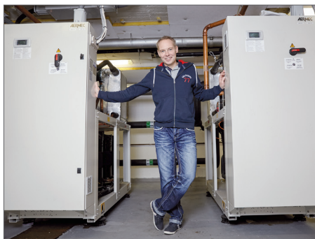
Vi överdimensionerar våra anläggningar men det går att köra med under 40 W per kvm, säger Daniel Hansson (på bild) VD för Energi & Klimatteknik. Det har vi bevisat nu.
