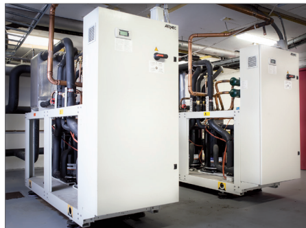
Två vätskekylaggregat från Aermec på vardera 350 kW och totalt åtta kompressorer betjänar idag 18 000 kvm i gallerian.
